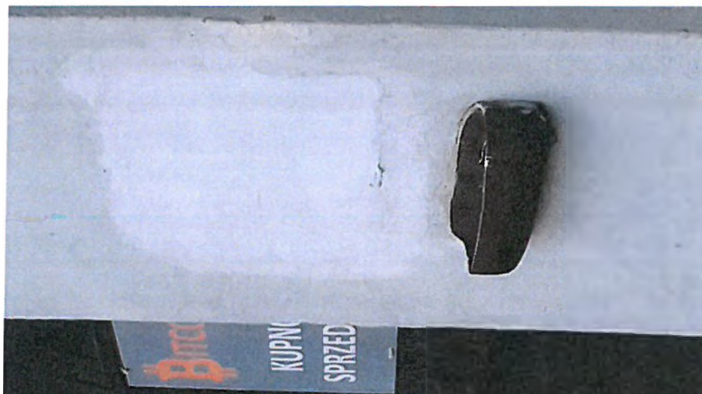
miejsce po zdemontowanej tablicy
